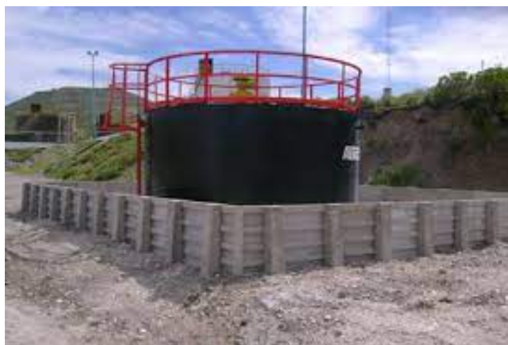
Figura 45: Almacenamiento de hidrocarburos
