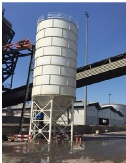
Figura 47: Silo de cemento de 385 m 3 de capacidad
