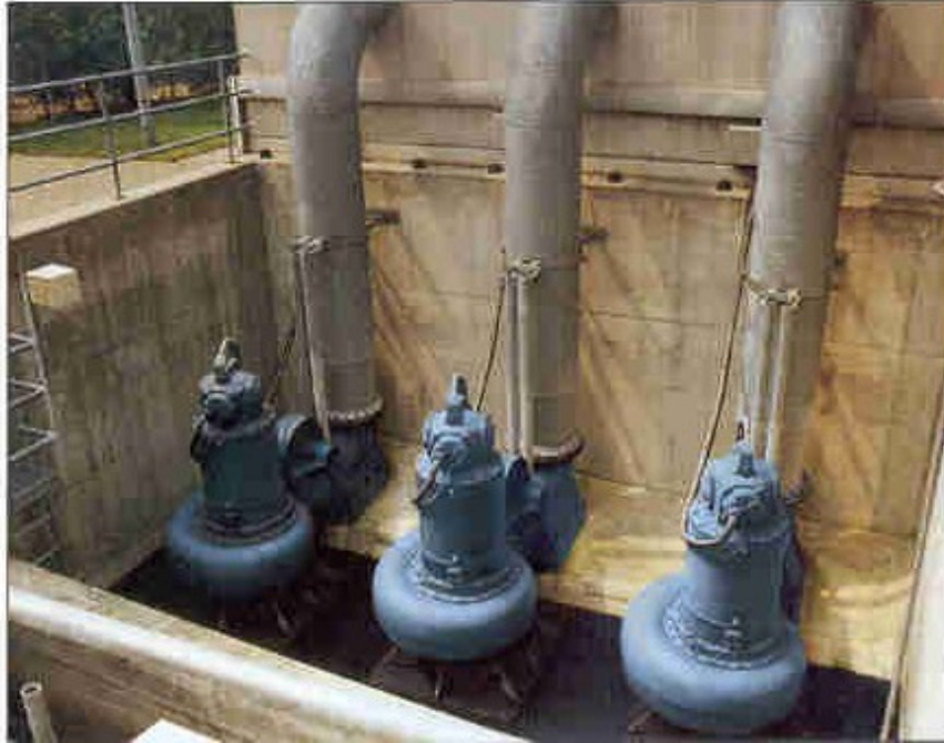
Fig. I.2 – Estación de bombeo para líquidos cloacales
