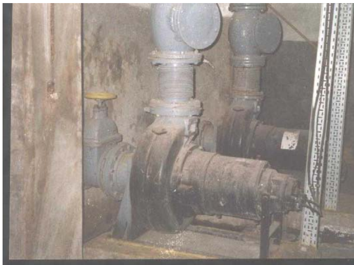
Fig. II.7.- Bomba cloacal con valv aspiración, amortiguador de vibraciones y valv retención
