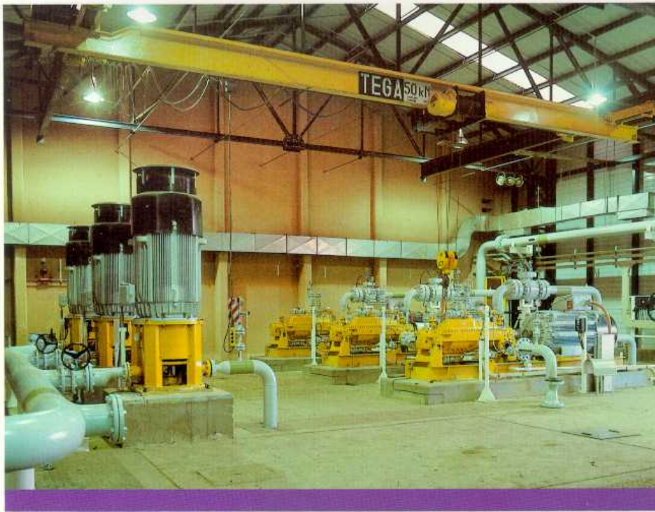
Fig. I.5.- Estación de bombeo con bombas verticales a la izquierda
